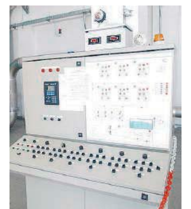
Quadro di controllo. L'acquedotto rimane osservato speciale
